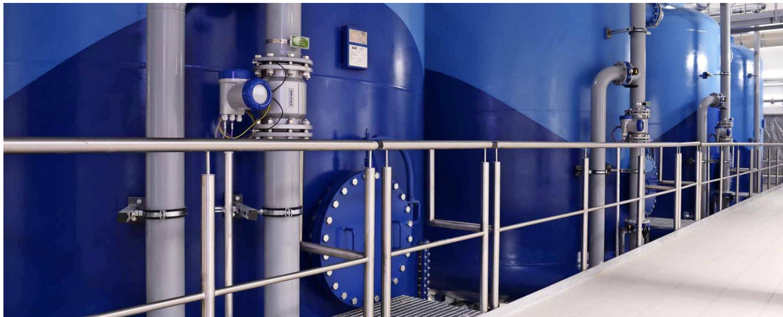
Im Wasserwerk Schweighausen wird eine Anlage verwendet, die mit Ionentausch Trinkwasser enthärtet und ohne Chemikalien auskommt. FOTOS: NOW
